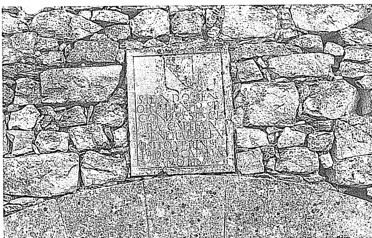
Detall, avui desaparegut, del molí de la Vall; fet construir per Joan Procopi de Bassecourt l'any 1806
